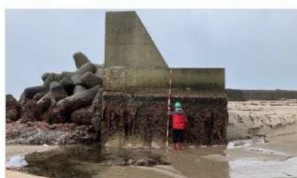
地盤隆起（鹿磯漁港（輪島市））
