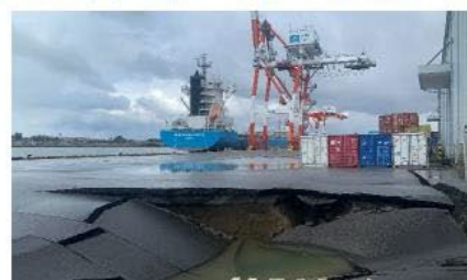
ふ頭用地陥没（金沢港（金沢市））
