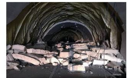
トンネル崩壊（国道249号）
