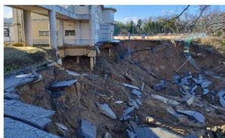
路面崩壊（金沢北陵高校（金沢市））
