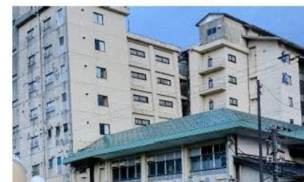
建物損壊（和倉温泉（七尾市））
